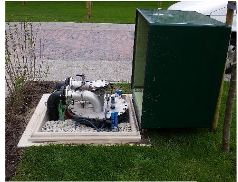
Figuur 3 GeoThermic bronkop
